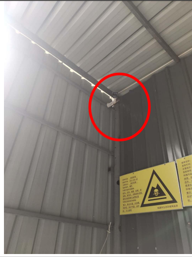
危废库内侧监控设施
