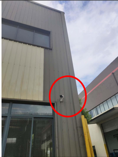
危废库外侧监控设施
